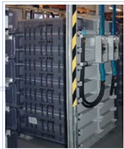
Рис. 10 Аккумуляторы Absolyte – установка в системе бесперебойного питания
