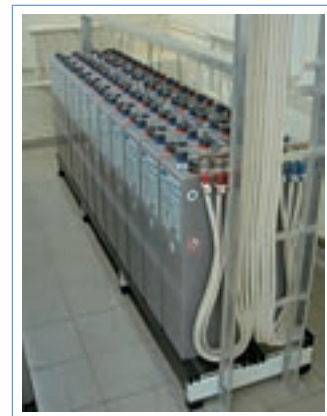
Рис. 18 Смонтированная батарея A600 OPzV
