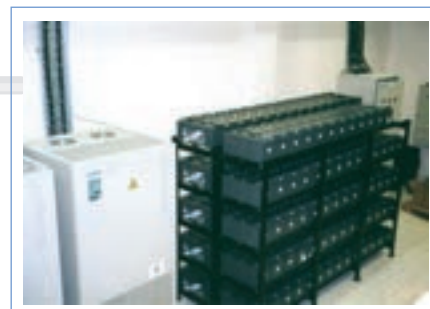
Рис. 16 Смонтированная батарея A500
