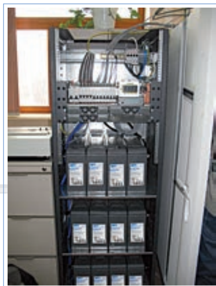
Рис. 15 Смонтированная батарея PC12/180FT
